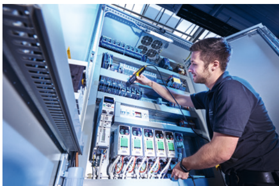
Prüfung eines Schaltschranks; laufende Qualitätskontrollen sind selbstverständlich
